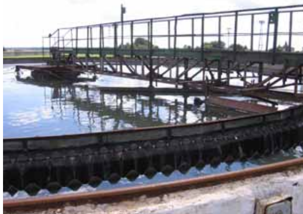
Водоотведение первичные отстойники
