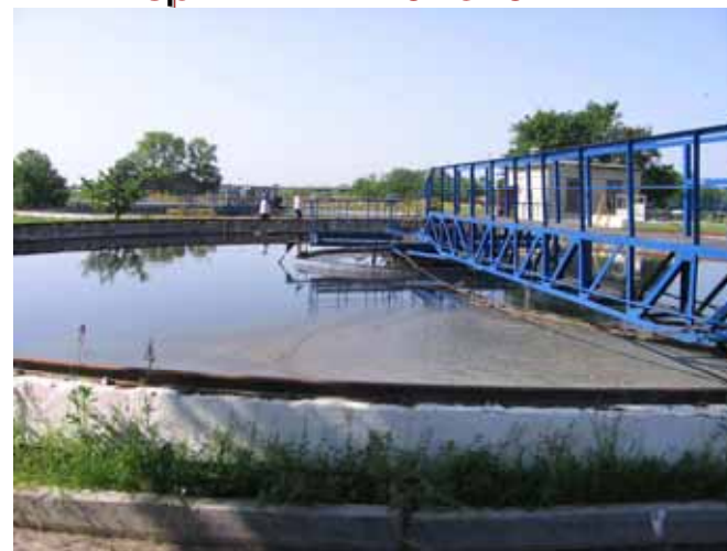
Водоотведение первичный отстойник
